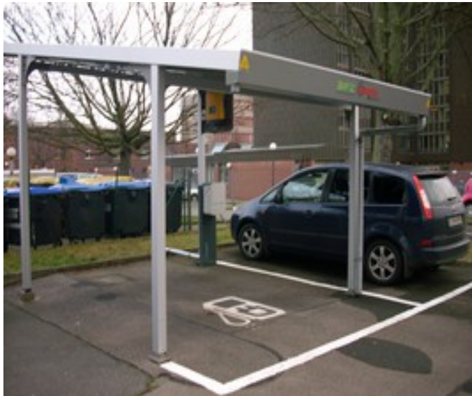
Elektroautoladestelle mit Solardach beim Berliner-Energie-Zentrum
