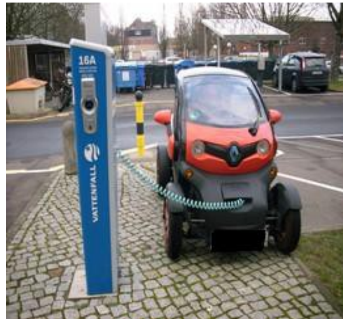
Elektroladestation Berliner- Energie- Zentrum
